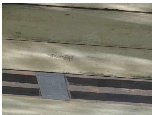
(a) 左幅 4-12#空心板底部渗水结晶
