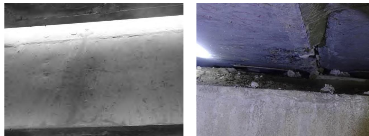
图 5.19-1 S231 大溪河大桥 2023 年定期检查病害
