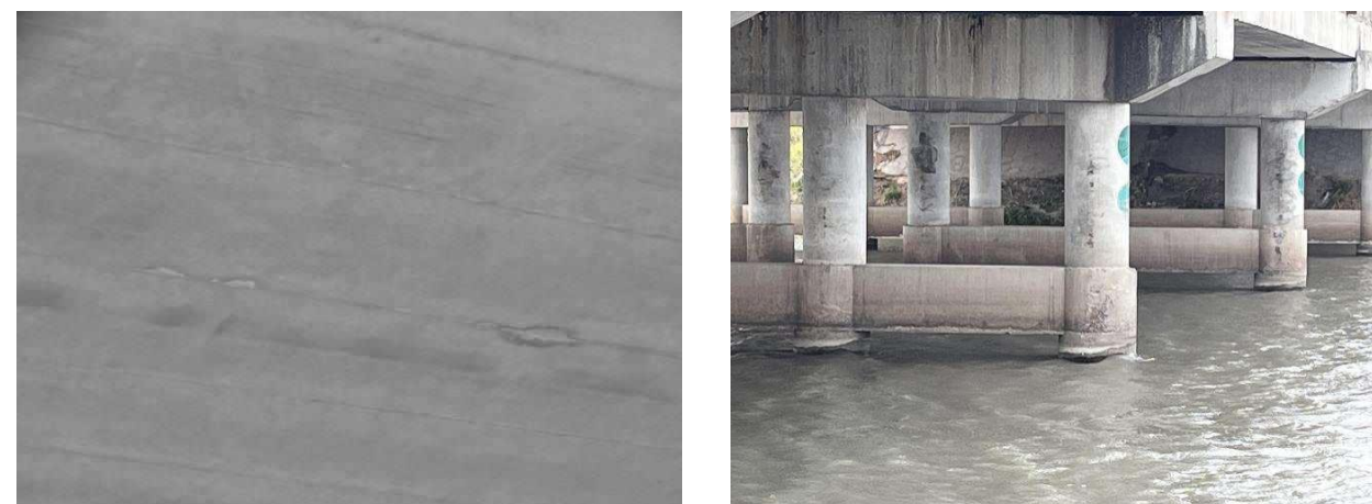
图 5.16-1 G344 海沟河大桥 2023 年定期检查病害
