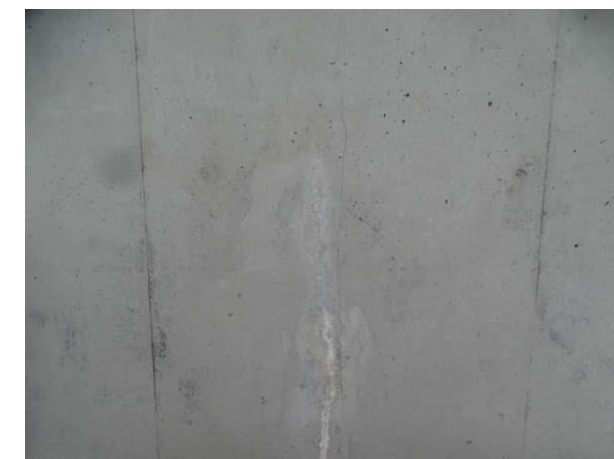
(b) 右幅箱外腹板竖向裂缝
