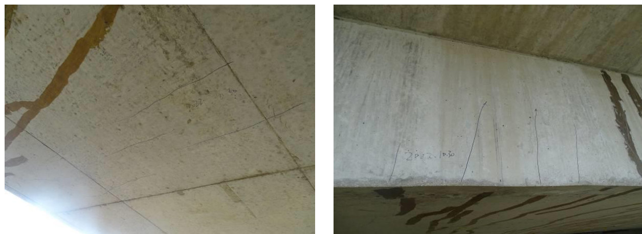
(a) 底板横向裂缝 (b) 腹板竖向裂缝
