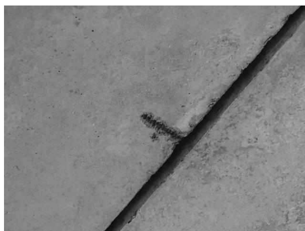
(b) 左幅空心板底板锈胀露筋
