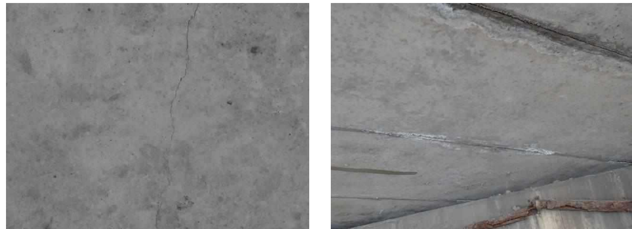
(a) 底板纵向裂缝
