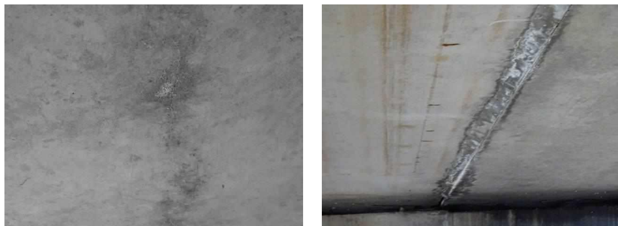
(a) 底板纵向裂缝、泛白吸附 (b) 铰缝渗水结晶
