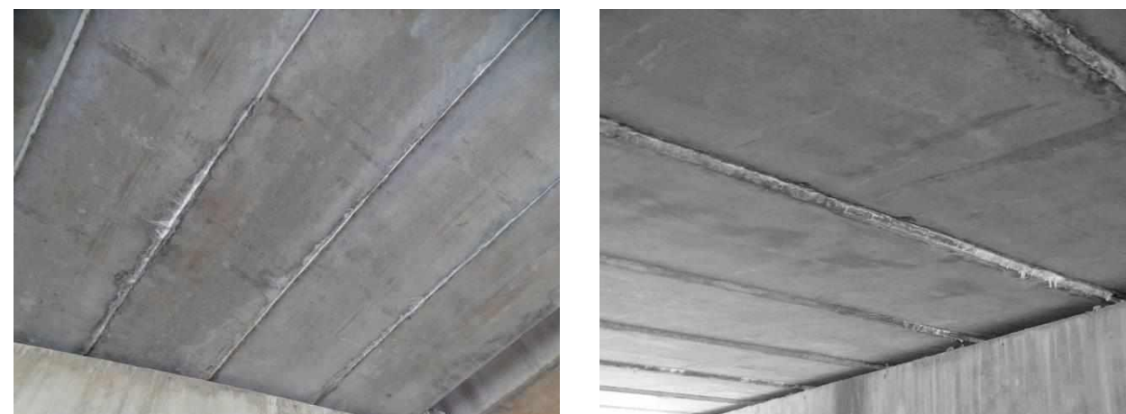
(a) 右幅 8-3# 铰缝渗水结晶 (b) 右幅 3-6# 铰缝渗水结晶
