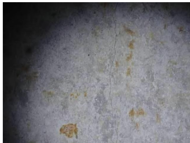
(a) 底板纵向裂缝
