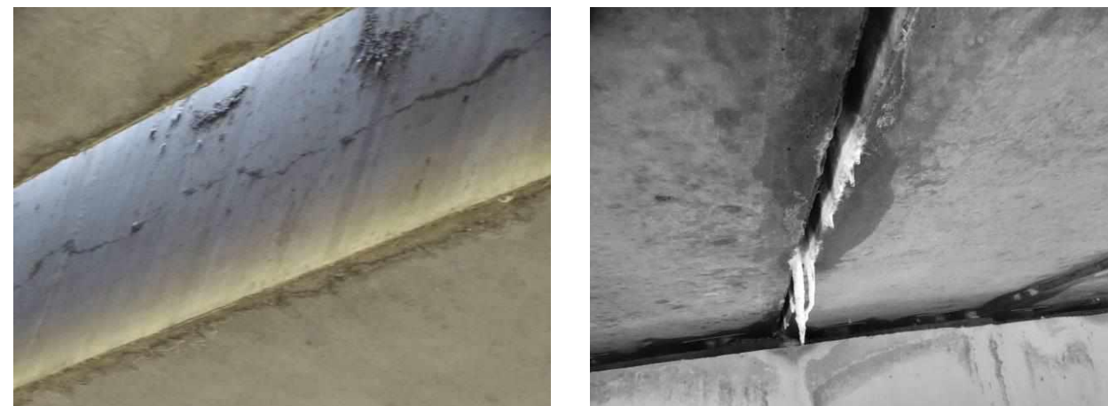
图 5.17-1 G344 洋汉河大桥 2023 年定期检查病害
