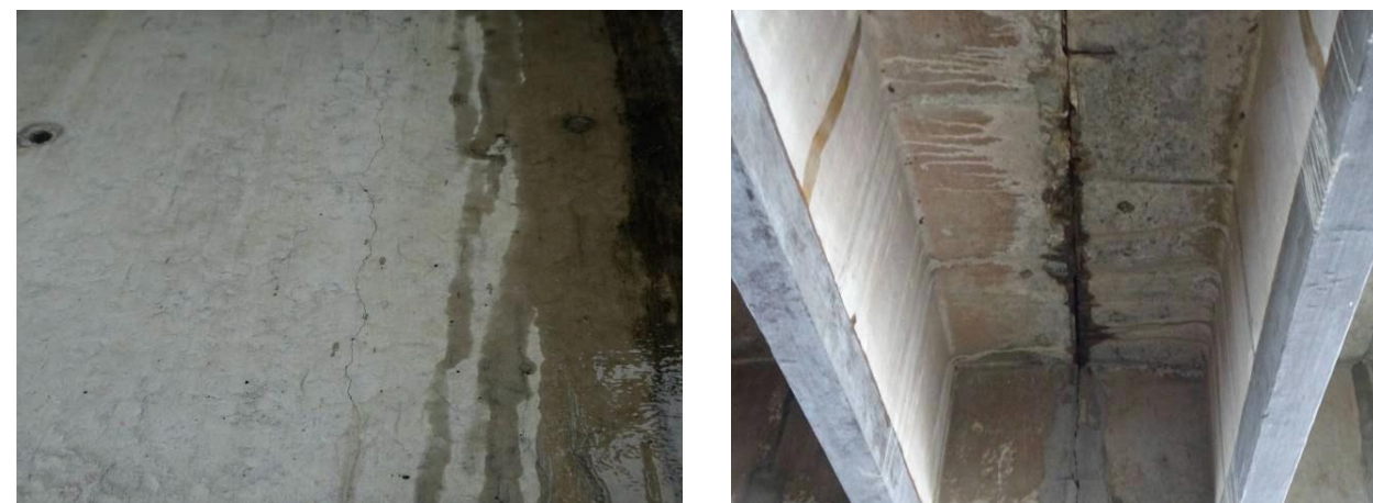
(a) T 梁 U 形裂缝
